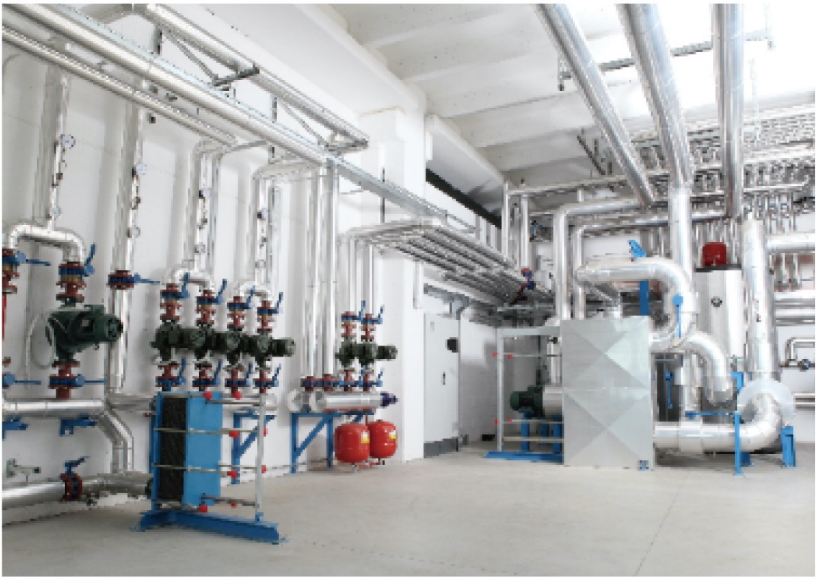
圖4 空調節能——無塵室工程
