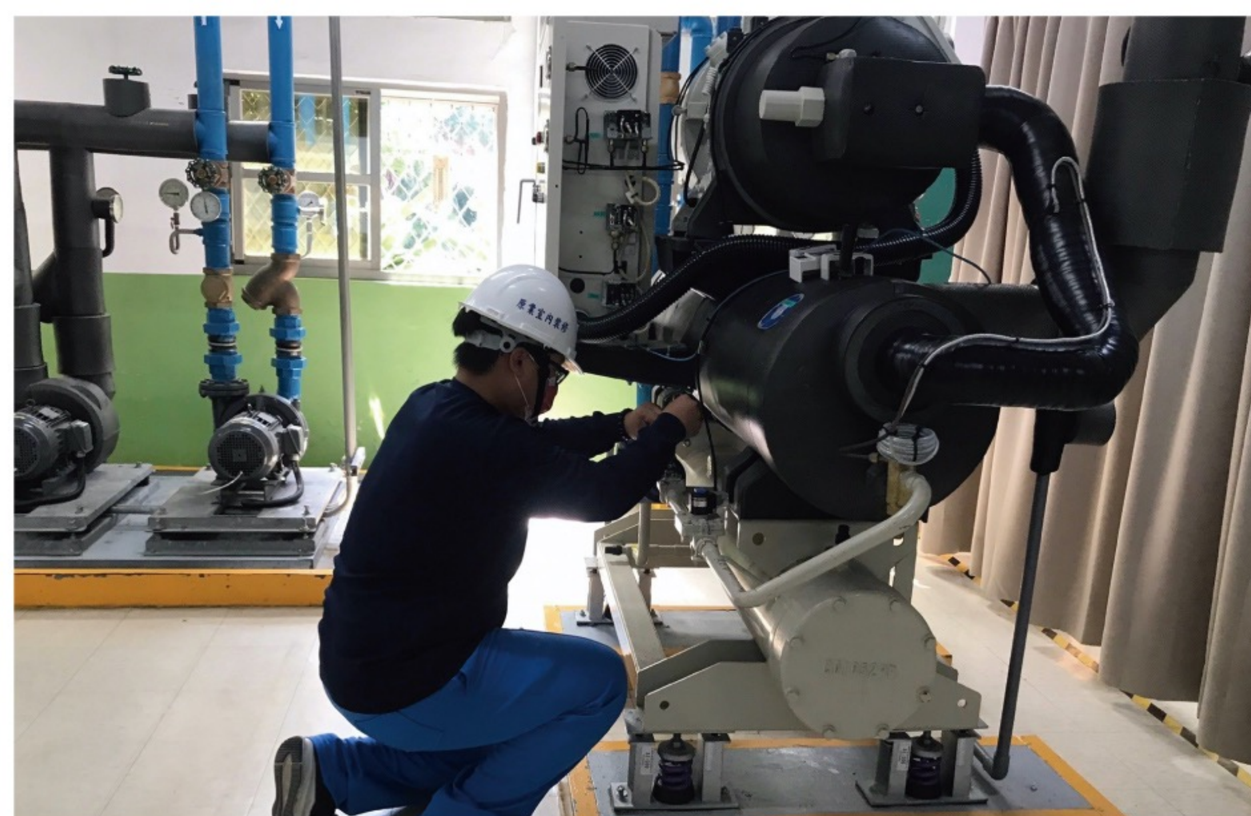
圖2 中央空調主機試俾調整
